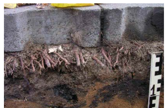
Dichtes Wurzelgeflecht unter Pflastersteinen
