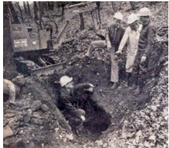
Abb. 48 Beginn der Grabungen mit der ersten Öffnung des Stollens Graf Wittekind Nr. 4 am 17.11.1986
