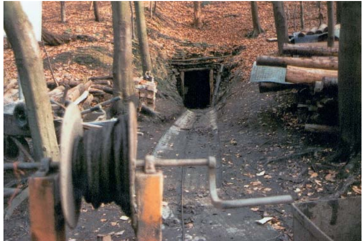
Abb. 177 Handwinde vor dem Stollen zum Herausziehen der Förderwagen
