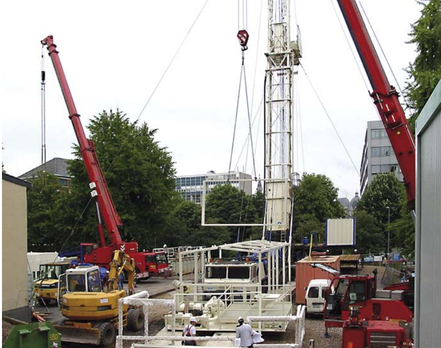
Abb. 26 Bohrung RWTH-1 im Stadtzentrum von Aachen, Vorbereitung der Einhausung des Bohrgerätes zum Schallschutz (Foto: B. OESTERREICH)
