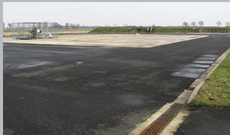
Bohrplatz Oppenwehe 1 (NRW) mit Boden- abdichtung und Flüssigkeitsauffangsystemen
