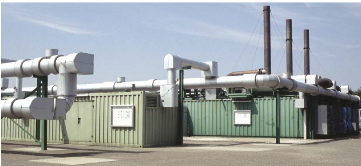
Abb. 16 Beispiel einer Grubengas-Gewinnungsanlage, ehem. Zeche Ewald in Herten
