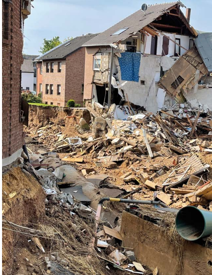
Erosionsrinne und Gebäudeschäden in der Ortslage Blessem nach dem Absinken des Wasserstandes in der Kiesgrube (27. Juli)
