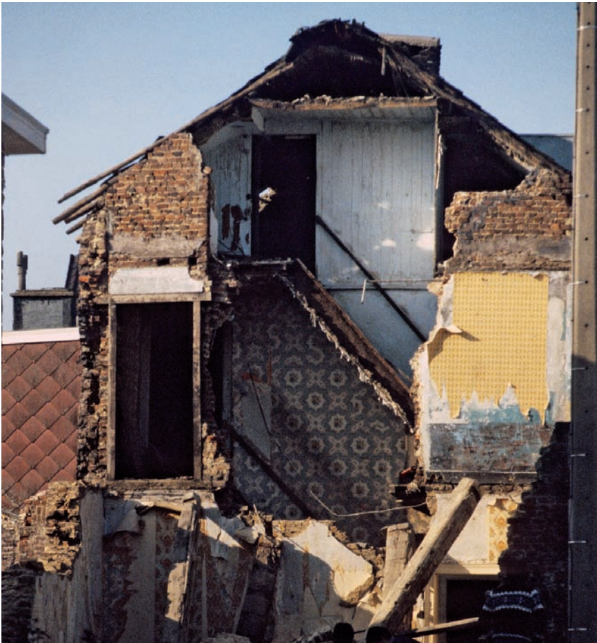
Abb. 13 Schäden durch das Erdbeben in Lüttich am 8. November 1983
